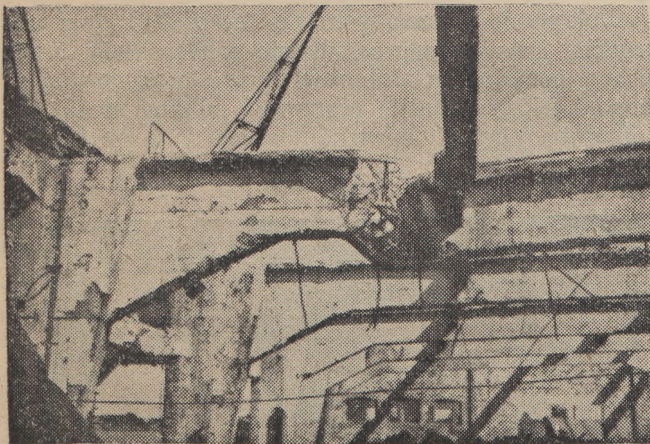
Rama boczna magazynu uszkodzona pociskiem.
