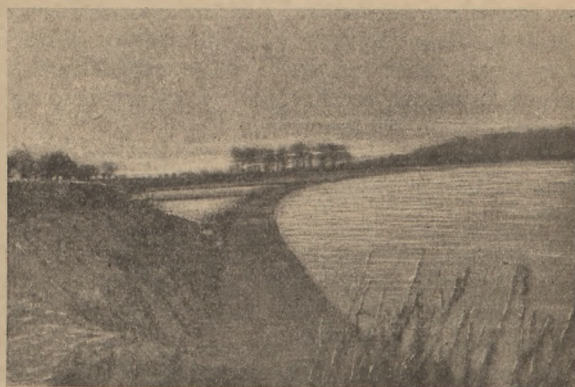
Rys. 6. Tama podłużna z koronką betonową po przejściu lodów i wody wiosennej.
