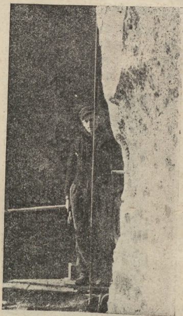
Rys. 5. Fragment zniszczonego betonu studzienki do zasuw.
