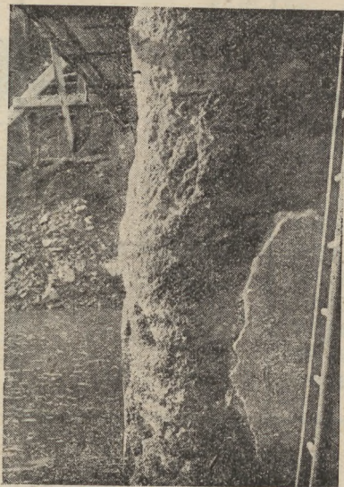
Rys. 4. Fragment zniszczonego betonu studzienki do zasuw.
