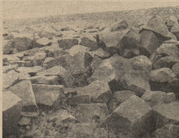
Rys. 4. Zniszczona okładzina na skarpie zapory w Otmuchowie.
