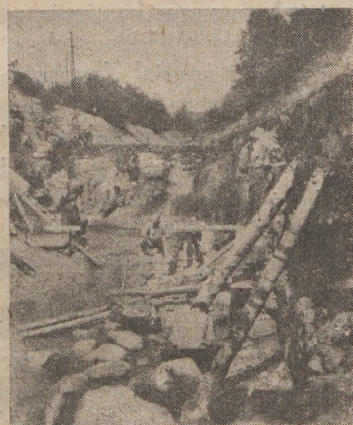
Rys. 7. .... uszkodzenia zabudowy potoku i trudności przy ich usunięciu....
