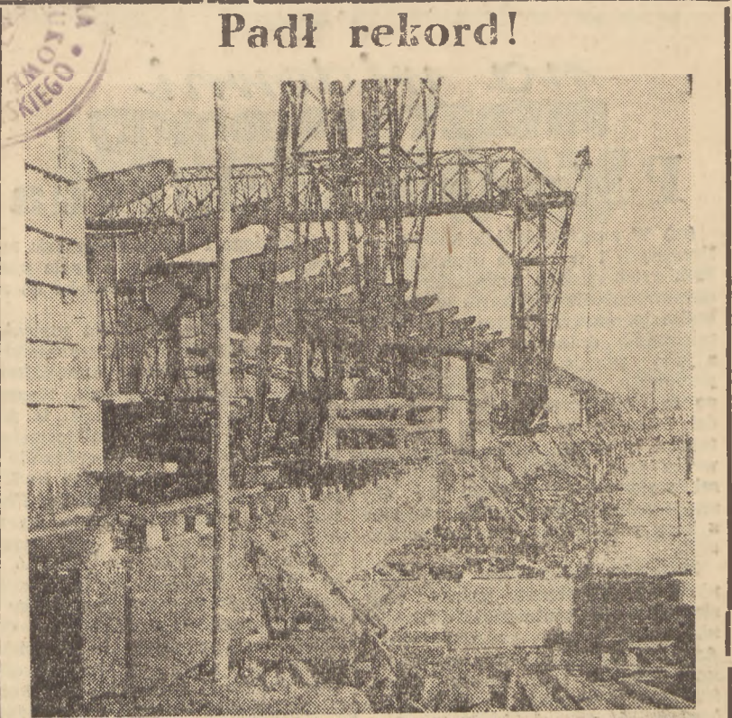
Padł rekord! Sładowa część trasy W — Z, most Śląsko-Dąbrowski jest już zmontowany. Montaż konstrukcji trwał tylko 75 dni! Inny odcinek trasy, tunel koło Pl. Zamkowego jest już gotowy w stanie surowym! Na str. 4-tej zamieszczamy sprawozdanie z wiecu 4 tys. robotników w tunelu W — Z, obszernie zaś sprawozdanie z wykonania czynu Przekongresowego — na str. 6. Na zdjęciu montaż ostatniego przęsła mostu. (API)
