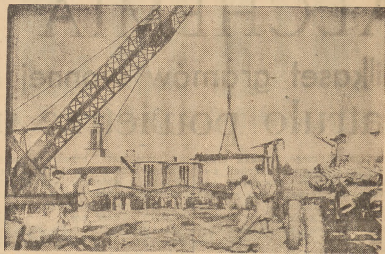
Budowa linii wysokiego napięcia — Śląsk — Łódź. Moment wyładowycaj elementów kranem motorowym syst. „Denika”.
