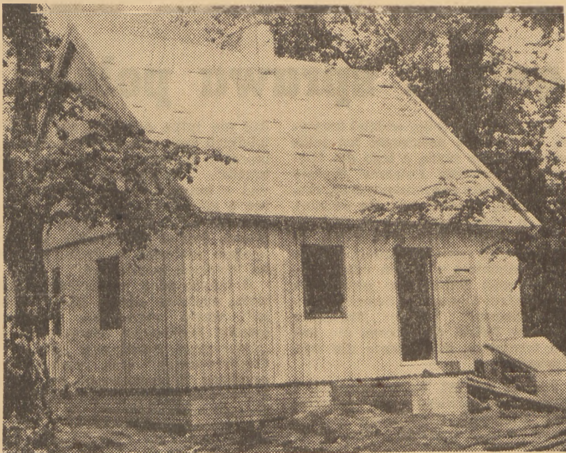
Domki Polski — zdystansował tzw. Domki Fliskie, tak pod względem urządzenia jak i ceny. Fragment domu w trakcie budowy.
