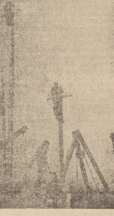
Wysokie kopaczki na trasie W — Z przesuwają się z miejsca na miejsce. Robotnicy podnoszą druty telefoniczne i przewody elektryczne, aby kopaczki mogły swobodnie się poruszać bez obawy zerwania drutów
