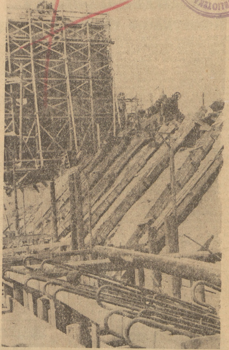
Tak wygląda dziś wykop na tunelu trasy W-Z na placu Zamkowym. Zabezpieczony rusztowaniem dom — jest to zabytkowa kamienica na rogu Krakowskiego Przedmieścia i Placu Zamkowego. Kamienica zostanie odbudowana po ukończeniu budowy tunelu. Drewniane ryny, leżące na zboczu wykopu, posłużą do wlewania betonu, z którego powstanie północna ścianka tunelu. (Fot. API)
