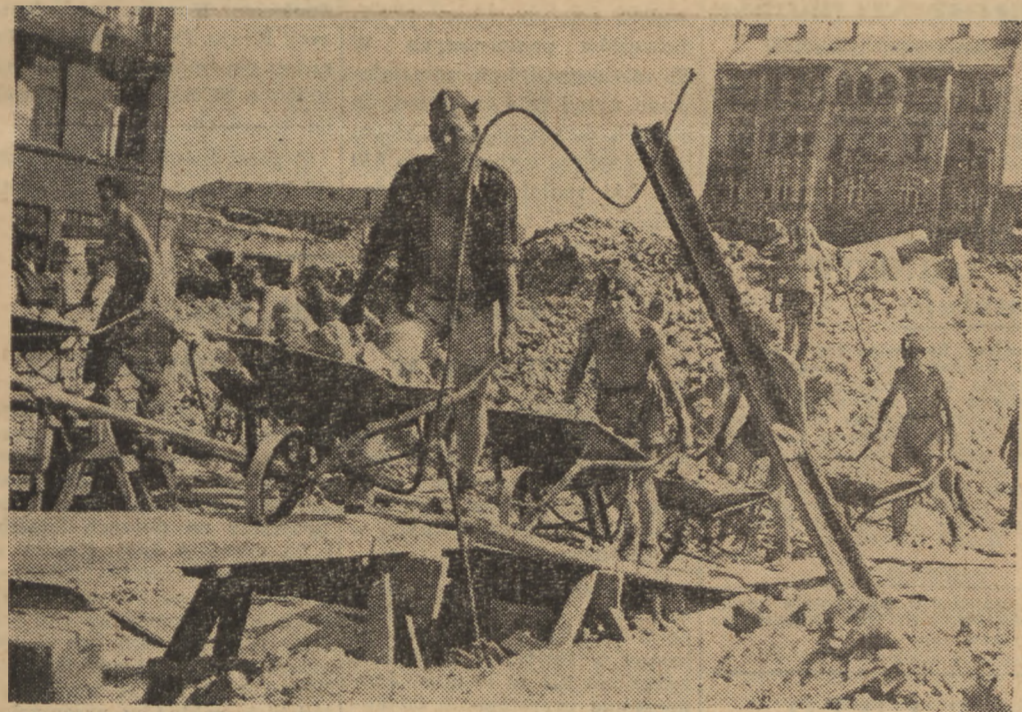
Brygada młodzieży czechosłowackiej, która wraz z innymi brygadami zagranicznymi bierze udział w odbudowie Warszawy, zajęła pierwsze miejsce pod względem wydajności pracy. Osiągnęła ona 191 procent normy
