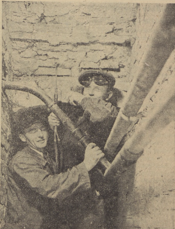
Zaloga Przedsiębiorstwa Instalacji Sanitarnych i Urządzeń Wodnych Budownictwa Przemysłowego w Warszawie stale poprawia wyniki pracy. Dnia 9 bm. w budynku „Arsenału” przy spawaniu „poziomów” (rury ciągnione do centralnego ogrzewania) pracownicy Przedsiębiorstwa tow. Teodor Przybylski — spawacz i Czesław Turkowski — jego pomocnik, ustalił nowy rekord odpowiadający 474 proc. normy, montując i spawając 65,8 m b. rur w czasie 1 godziny 47 minut. Łączny ich zarobek wyniósł 12.752 zł. Tow. tow. Przybylski i Turkowski oświadczyli, że będą się starać stale utrzymywać to tempo pracy. (A. N.)
