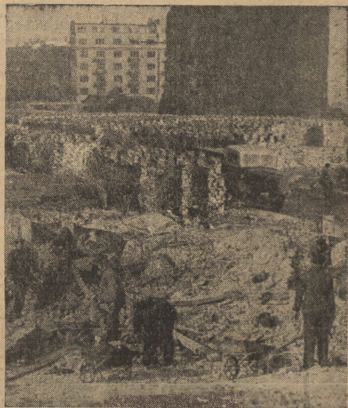
Wzdłuż placu, na którym stanie w Warszawie Dom Młodzieży Polskiej piętrzą się piramidy równo ułożonych i oczyszczonych ogień, wyszukanych z rozbioru ruin.
