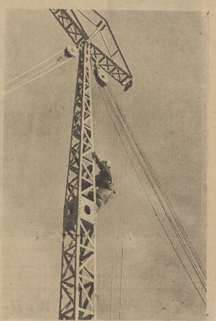
Przy budowie „Domu Słowa Polskiego“ zastosowano urządzenia techniczne i maszyny. Na zdjęciu potężny dźwig do transportu budulca
