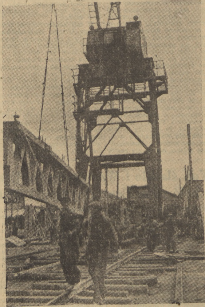
Wielki dźwig, który był na wystawie we Wrocławiu, pracuje przy zestawieniu żelbetonowych elementów hal w Fabryce Urzędów Radiowych w Warszawie. Na fotografii przewoźnik podciągu żelbetonowego, na którym spoczywał będzie dach hali fabrycznej. Foto AB
