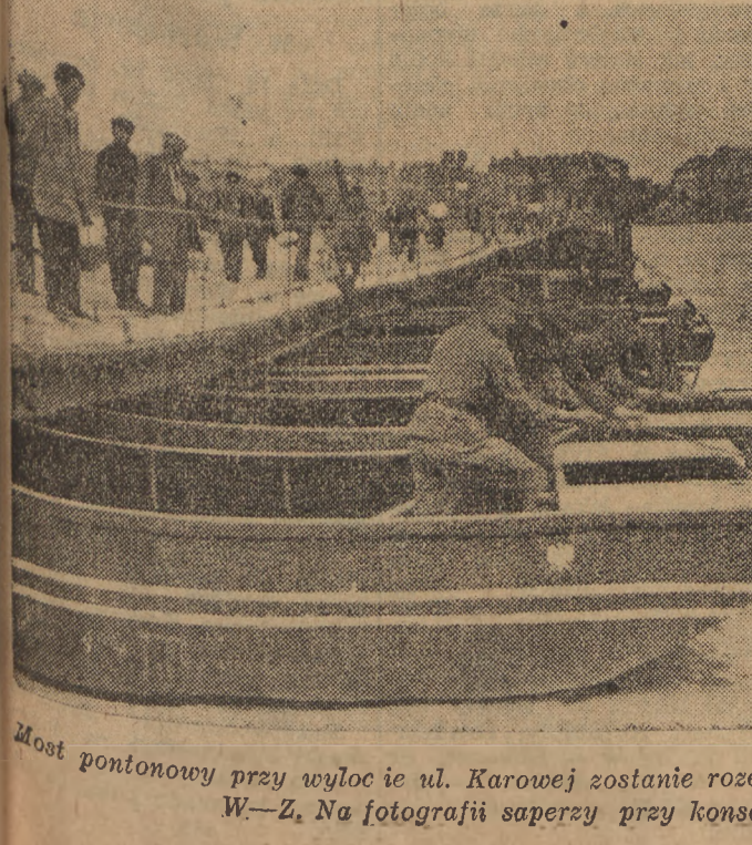
Most pontonowy przy wylocie ul. Karowej zostanie rozebrany w dniu otwarcia trasy W—Z. Na fotografii saperzy przy konserwacji mostu. Foto WAF
