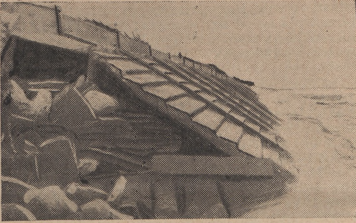
Masywna tama betonowa systemu holenderskiego pomiędzy Karwią a Karwieńskimi Błotami kompletnie rozbita przez fale morskie.
