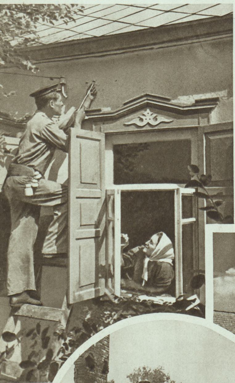
Высоковольтная линия передачи подает ток районной электростанции в колхоз им. Шевченко, Харьковской области. В новый дом колхозницы А. Шаруды проводится электричество.
