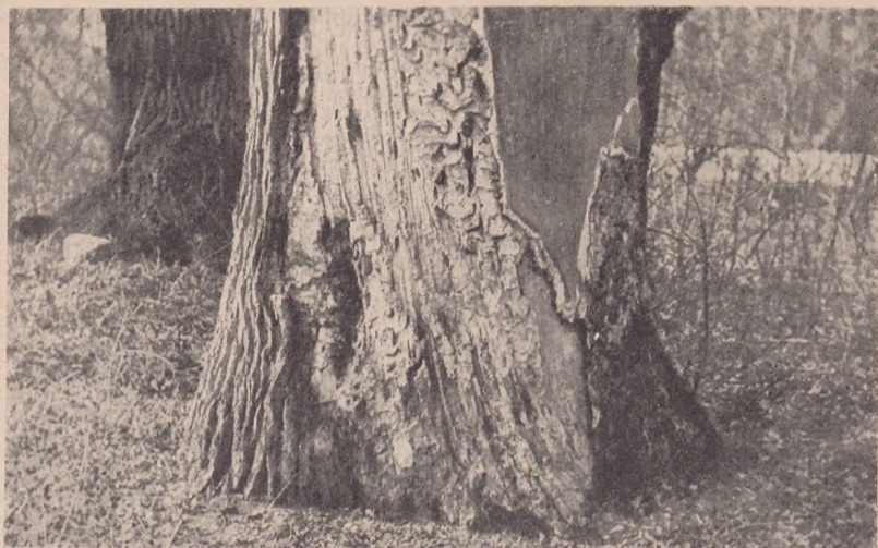
Ryc. 26. Zbyt cienka warstwa izolacyjna, założona na wypróchniałym pniu, szybko odpada.
