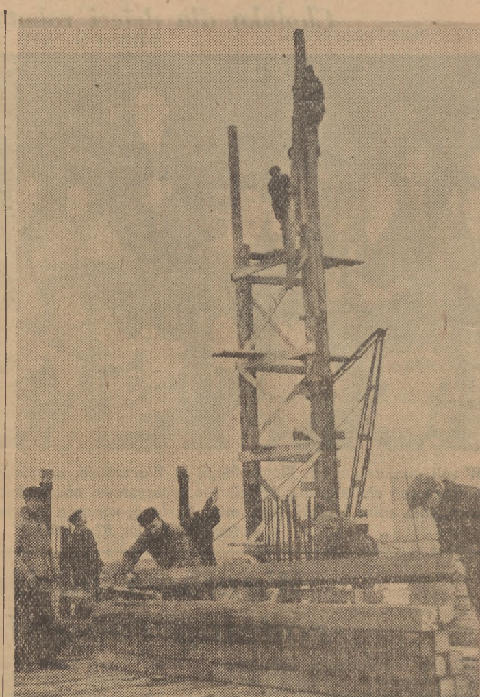
Władysław Wójcik i jego brygada — cieśle zatrudnieni przy budowie GUS, przy wysokiej jakości pracy, wykonują około 250 proc. normy. Widzimy ich na zdjęciu w czasie pracy. Foto AR
