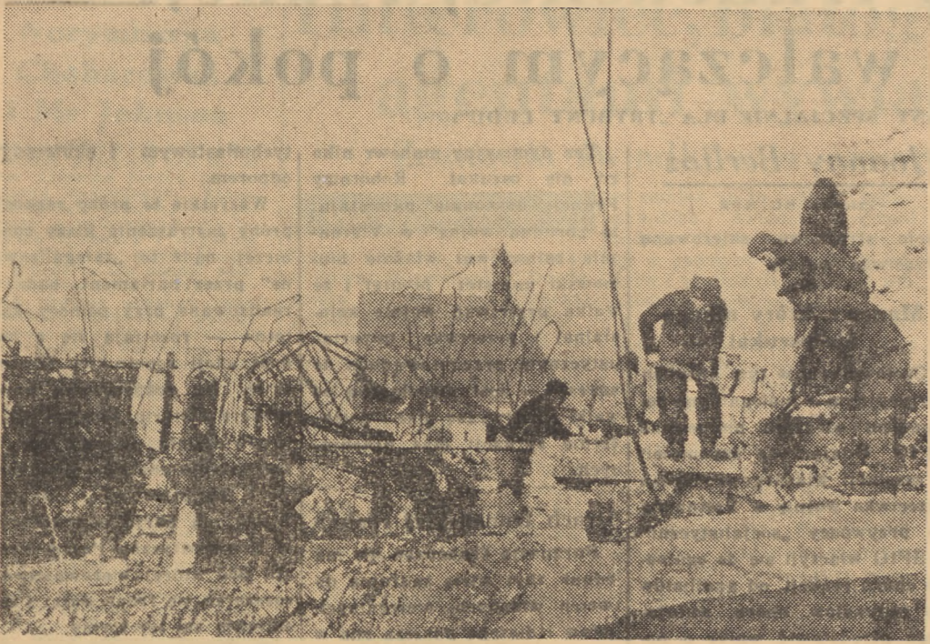
Obecnie prowadzone są u szybkim tempie prace przy rozbiórce ruin Zamku Królewskiego w Warszawie. Jak wiadomo zgodnie z uchwałą Sejmu Ustawodawczego RP Zaimek będzie odbudowany do 1955 roku
