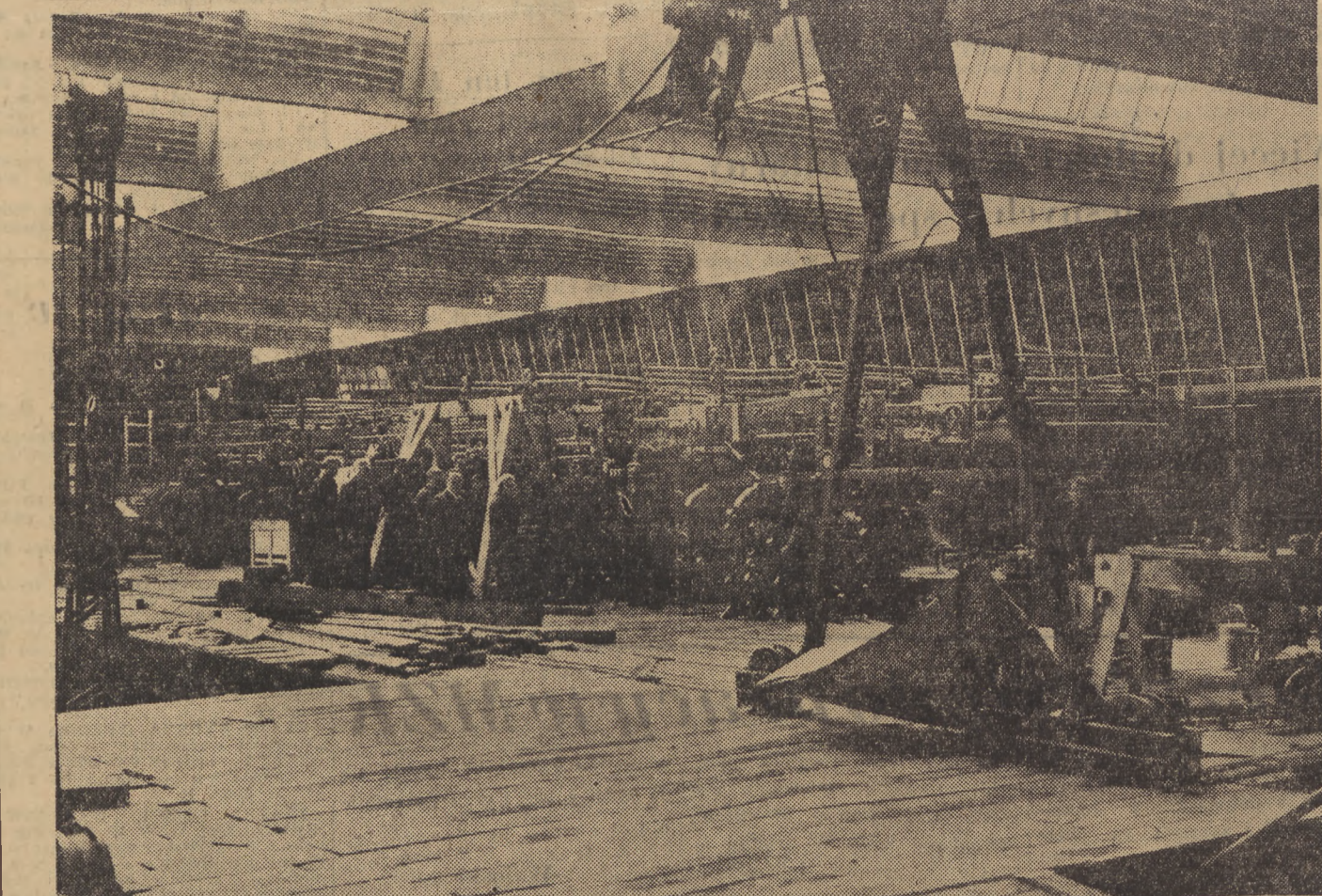
Na terenie budowy Domu Słowa Polskiego trwają intensywne prace. Podczas, gdy załogi budowlane wykańczają główną halę produkcyjną — w hali tej montuje się jednocześnie 96-stronicową maszynę rotacyjną, która w dniu 22 lipca rozpocznie pracę. Na zdjęciu montaż maszyny rotacyjnej
