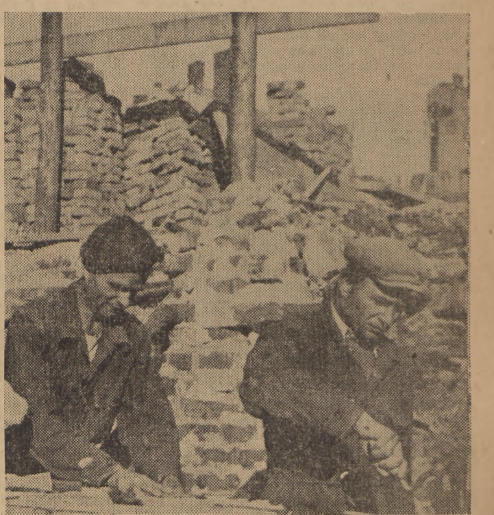
Inicjator współzawodnictwa o tytuł najlepszego murarza w Polsce, tow. Edward Słupecki, pracuje przy budowie Marszałkowskiej Dzielnicy Mieszkanowej. Widzimy go na zdjęciu wraz z pomocnikiem podczas stawiania ściany frontowej bloku 6-b.
