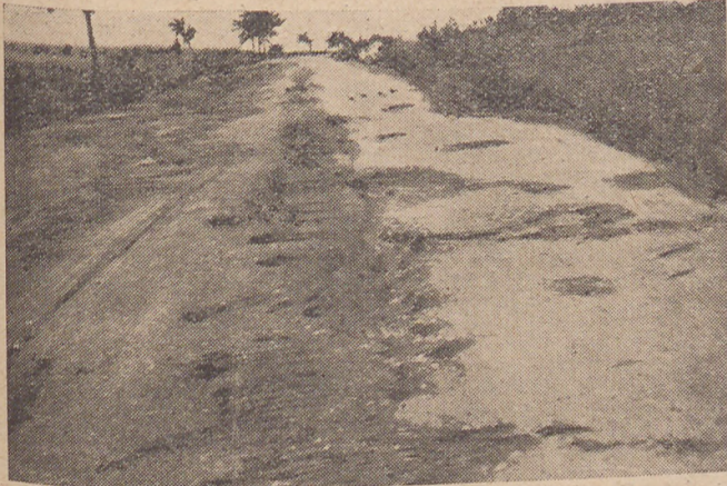
Fot. 3. Ziemie Odzyskane — Pow. Rzepin — Droga powiatowa Czarnów — Słubice, naw. smołowana. Stan z czerwca 1947 r.
