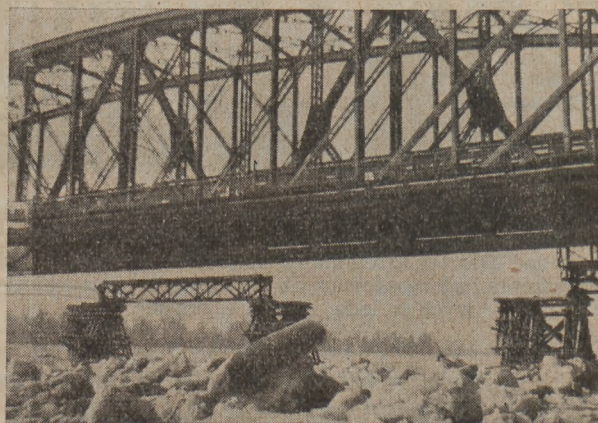
Rys. 14. Zniszczony przez lody kolejowy most przewoźniczy. Kratownica, która jeszcze stoi na jarzmach, została potem również zwalona.
