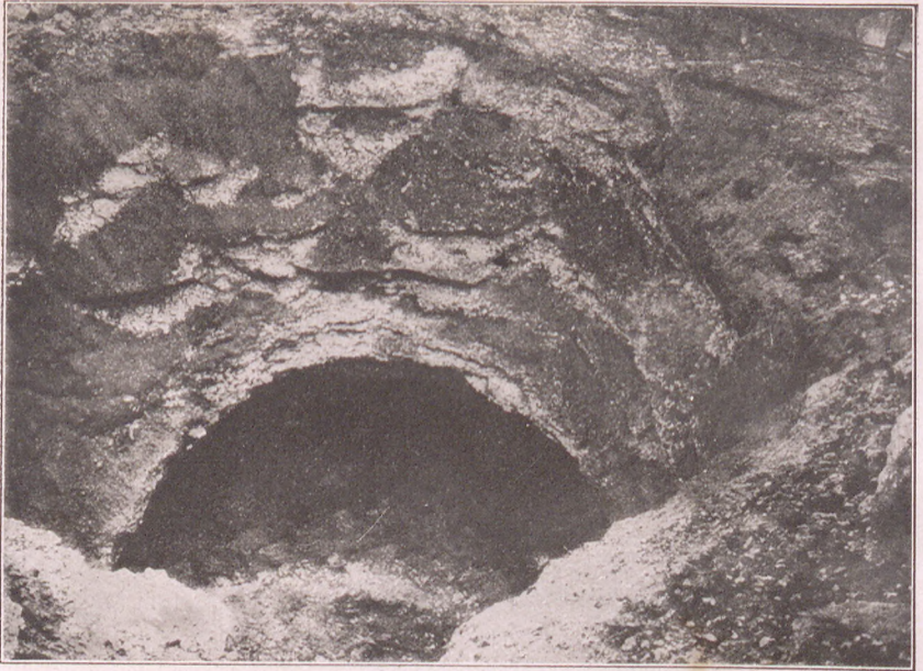
Fort Wavre-Ste. Catherine Betondecke der Kaserne, durchschlagen von einem 42-cm-Geschöß
