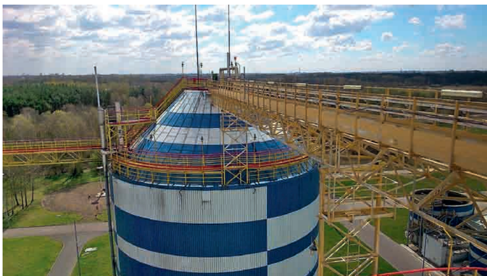
Rys. 3. Pokrywa jednej z czterech zamkniętych komór fermentacyjnych funkcjonujących w Grupowej Oczyszczalni Ścieków w Łodzi
