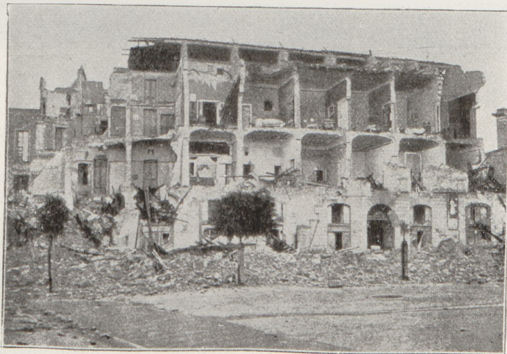
Fig. 202 Eingestürzte Hausfront, Piazza Cavalotti, Messina (Aufnahme von Ch. Trampus, Paris, in Ill. Zeitung aus Hobbs-Ruska)
