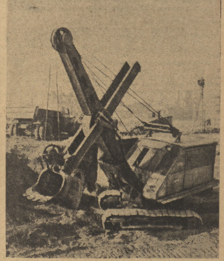
Na Muranowie trwają prace przygotowawcze pod budowę domów mieszkalnych. Przy wykopach pracują dwie koparki elektryczne produkcji radzieckiej. W ciągu 6 godzin koparka taka wydobywa około 600 metrów sześciennych ziem.
