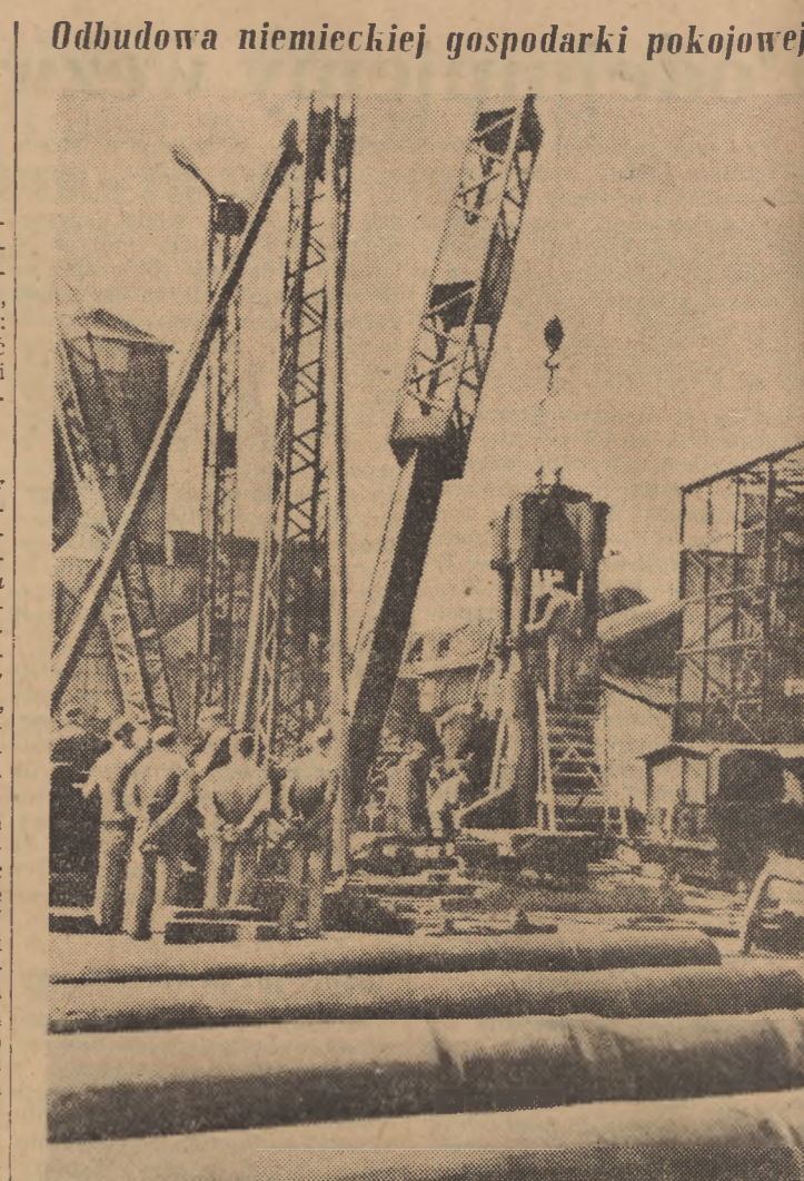
W Niemieckiej Republice Demokratycznej trwają prace przy budowie wielu zakładów przemysłowych zniszczonych w czasie działań wojennych. Na zdjęciu: montowanie dostarczonej przez Związek Radziecki prasy hydraulicznej w warsztatach walcowanych stalowni Groeditz. Foto Hius
