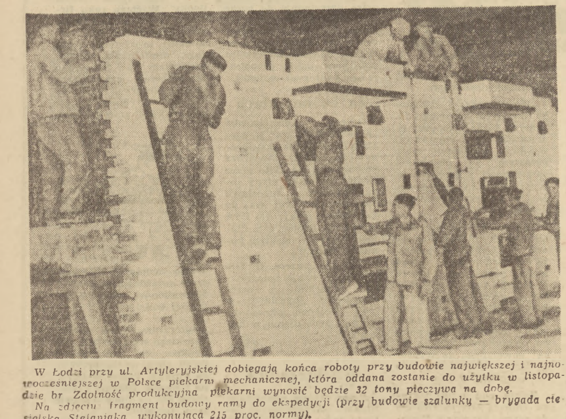
W Łodzi przy ul. Artyleryjskiej dobiegają końca roboty przy budowie największej i najnowszej w Polsce piekarni mechanicznej, która oddana zostanie do użytku w listopadzie br. Zdolność produkcyjna piekarni wynosić będzie 32 tony pieczywa na dobę. Na zdjęciu: fragment budowy ramy do ekspedycji (przy budowie szalunku — brzygady ctełsińska Stejaniaka, wykonująca 215 proc. normy).
