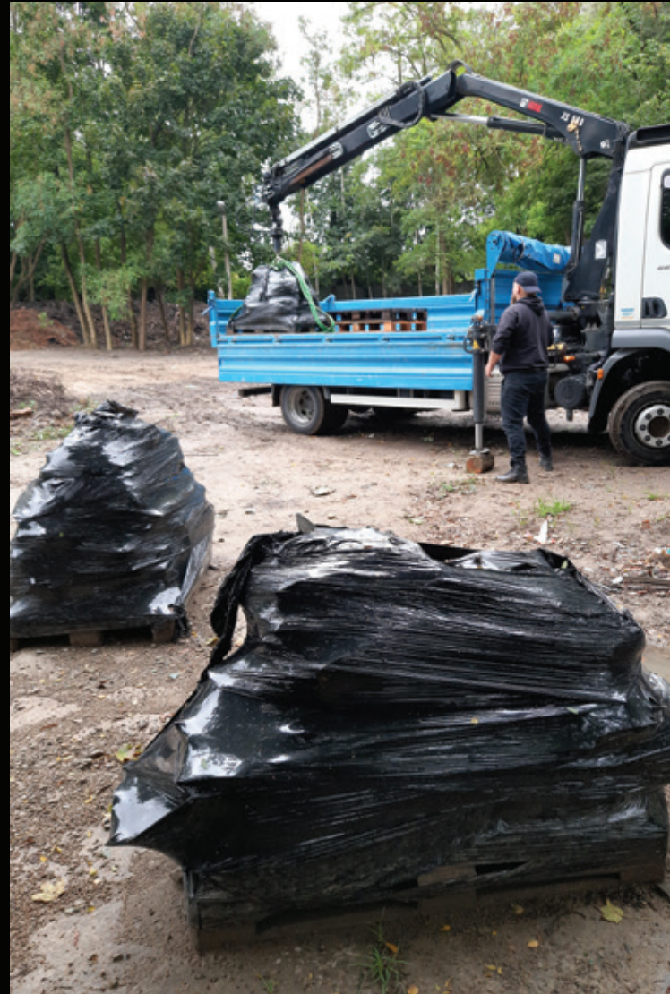
Akcja usunięcia niebezpiecznego dla zdrowia eternitu z należącej do PG nieruchomości przy ul. Sobieskiego – krok w stronę przywrócenia przyrodniczych walorów Królewskiej Doliny
