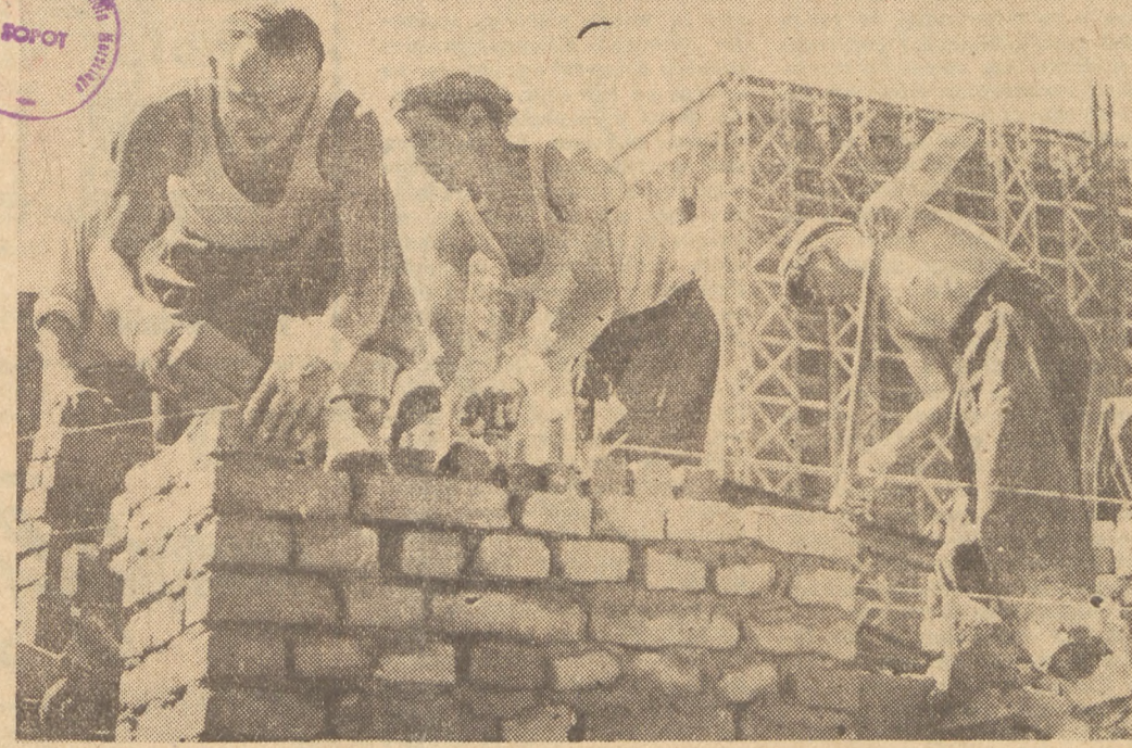
Heniek rozprawdza szufłą zaprawę, Tadek podaje po dwie cegły, które Stach w mgnieniu oka uклада w równe rzędy. Trójka pracuje szybko, ale nie nerwowo. Foto W. Zaczek
