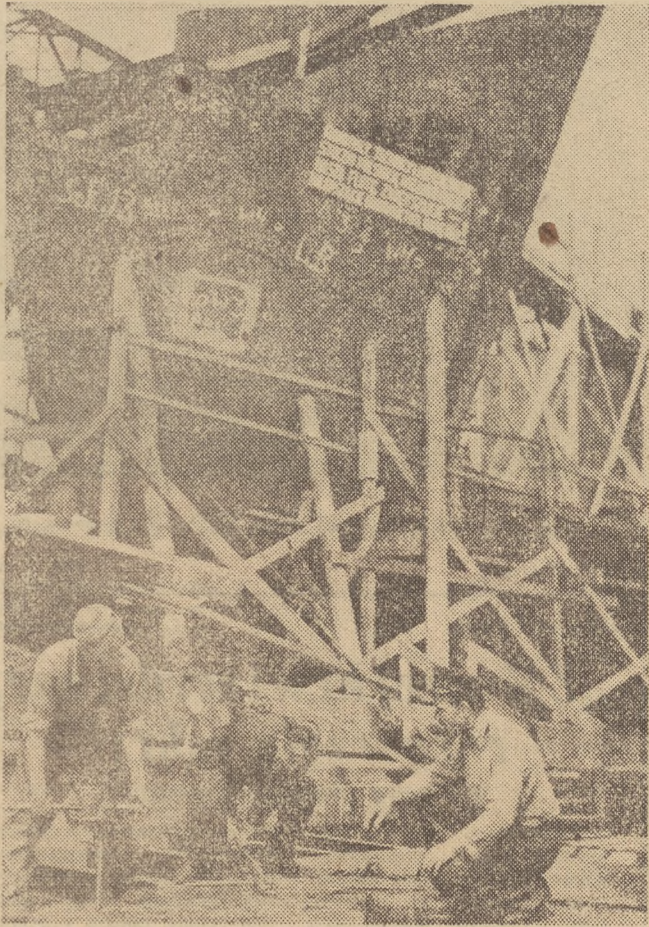
Oddbudowana Stocznia Szczecińska rozpoczęła budowę pełnomorskich statków. Na zdjęciu: brygada Leona Kizniwicza przy budowie pokrycia burtowego rudowęglowca.
