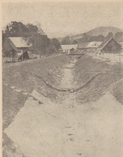
Ryc. 6. Żłób kamienny na rzece Łopuszance. Na pierwszym planie wyrwa załatwana betonem
