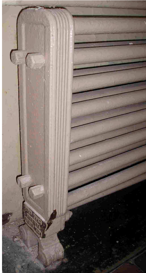
Kaloryfer z lat 1900–1904 z ozdobną ścianką boczną w małej sali audytoryjnej (E-27)
