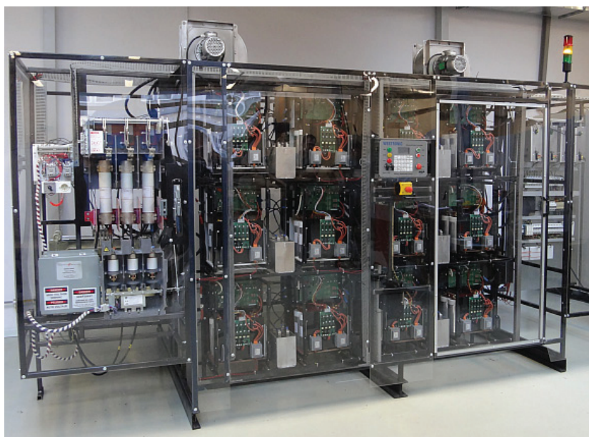
Stanowiska badawcze z falownikiem napięcia do silników o mocy 600 kW i napięciu 3,3 kV stosowanych w napędach do pompowania ropy naftowej – badania dla firm MMB Drives sp. z o.o. i Alkhorayef z Arabii Saudyjskiej
