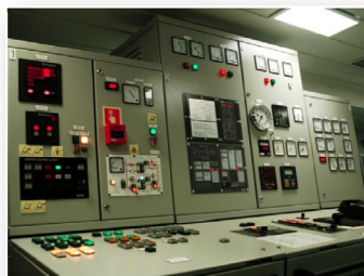
Urządzenia rozdzielcze nn i SN
