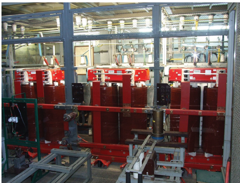
Fotografia urządzeń zmodernizowanej zwarciovni
