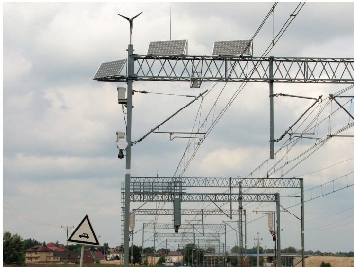
Monitoring odbieraków prądu na linii kolejowej, widok stanowiska MOP
