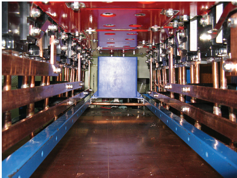
Konstrukcja trójpoziomowego falownika napięcia o mocy 160 kW w fazie montażu – falownik opracowany w ramach projektu rozwojowego
