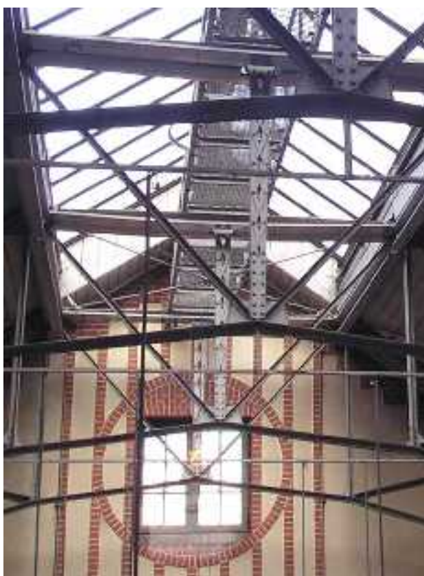
11. Gmach Wydziału Elektrotechniki i Automatyki – część 2. Widok na górne partie hali maszyn i pierwotną, metalową konstrukcję dachu. Stan z 2004 roku.
