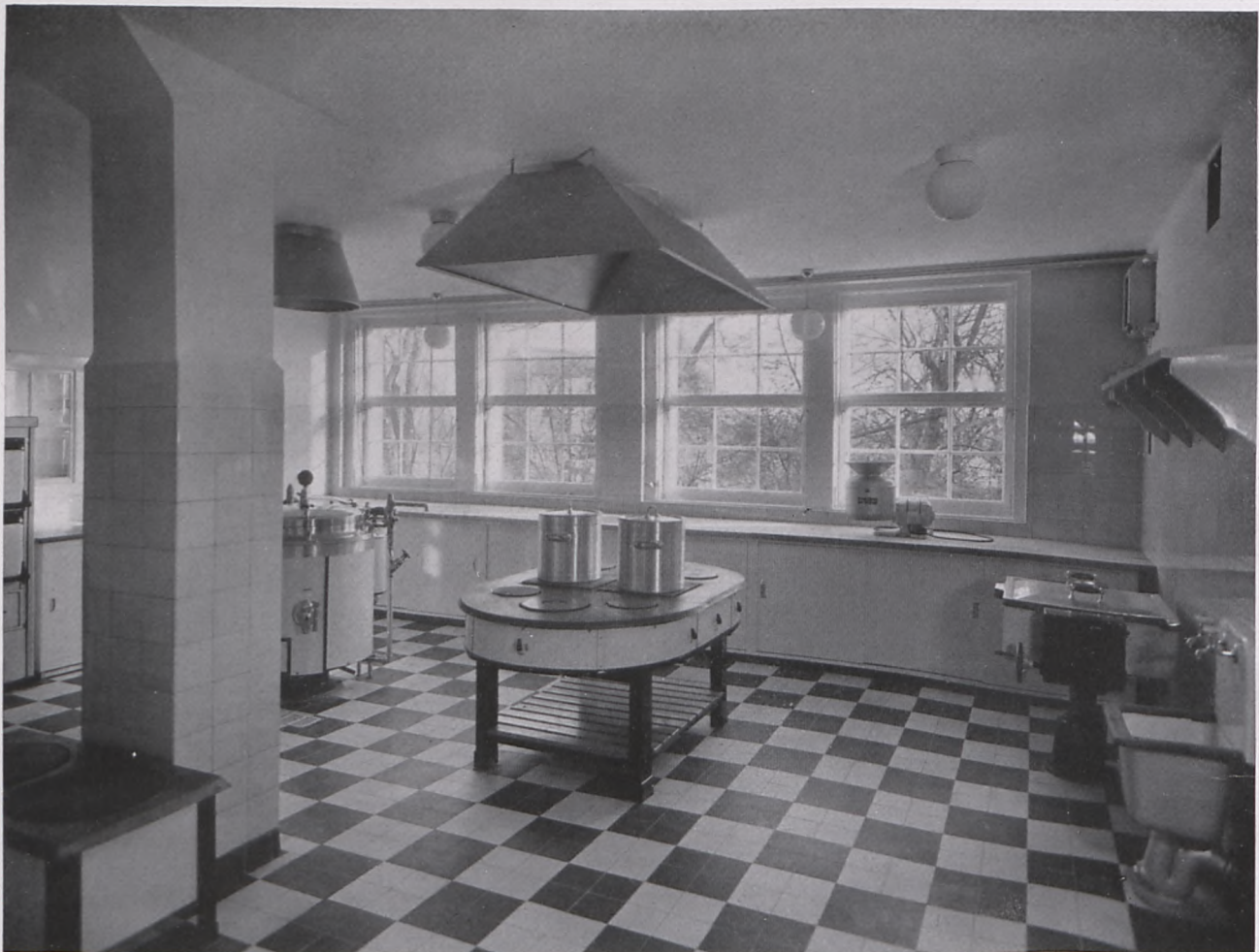
»KÜCHE« KLIMA-ANLAGE ZUR BE- UND ENTLÜFTUNG DES VOLL-ELEKTRISCHEN KOCHBETRIEBS
