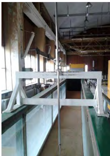
Fot. 6.2. Szpilka wodowskazowa do pomiarów rzędnych zwierciadła wody w kanale uchylnym.
