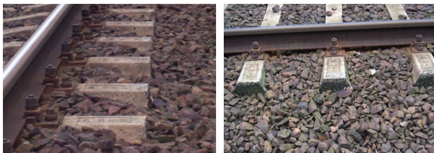
Rys. 10.21. Brak podsypki od czoł podkładów
