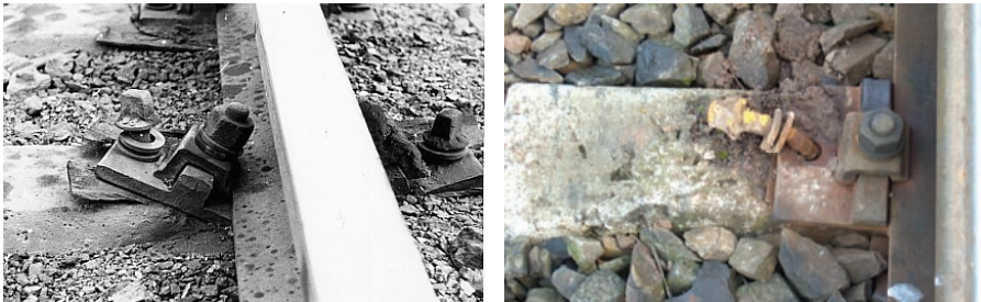
Rys. 10.24. Pęknięta podkładka żebrowa i wkręt [1]
