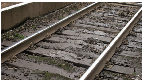
Rys. 3.56. Wychłapy powstałe w wyniku zanieczyszczenia podsypki [9]
