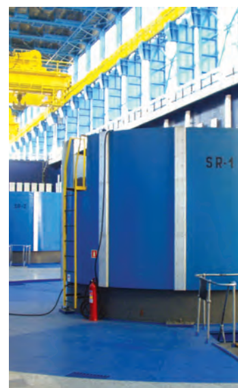
Fot. 2. Hala maszyn – silniki rozruchowe, maszyny wytwórcze, widok pokrywy generatorów
