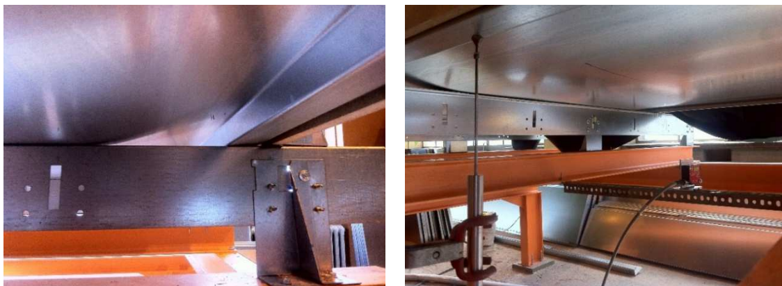
Rys. 44. Oparcie się powierzchni lica kasetonu o systemowy ruszt podporowy w wyniku działania parcia wiatru. Fot. P. Lewandowski.
