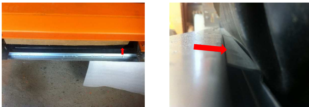
Rys. 55. Wysuwanie się krawędzi dolnej kasetonu z systemowego zamka. Fot. P. Lewandowski.
