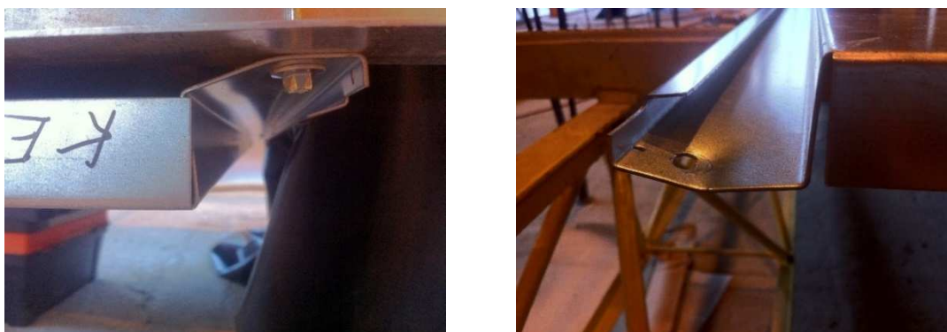
Rys. 54. Deformacje plastyczne w okolicach łącznika przy obciążeniu ssaniem wiatru. Fot. P. Lewandowski.
