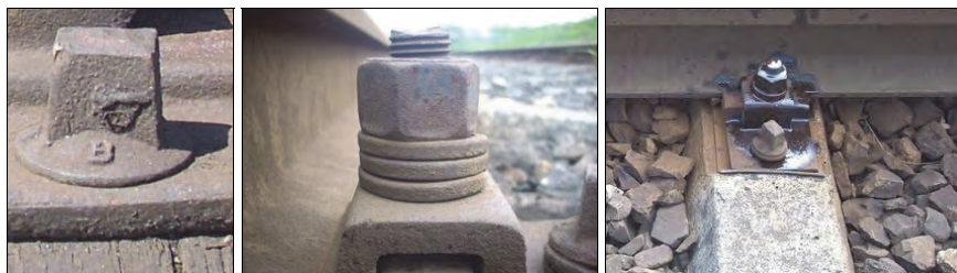
Rys. 3.28. Dokręcony wkręt do podkładki żebrowej i luz między zwojami pierścienia sprężystego trzyzwojowego oraz zakonserwowana śruba stopowa (G. Stencil)
