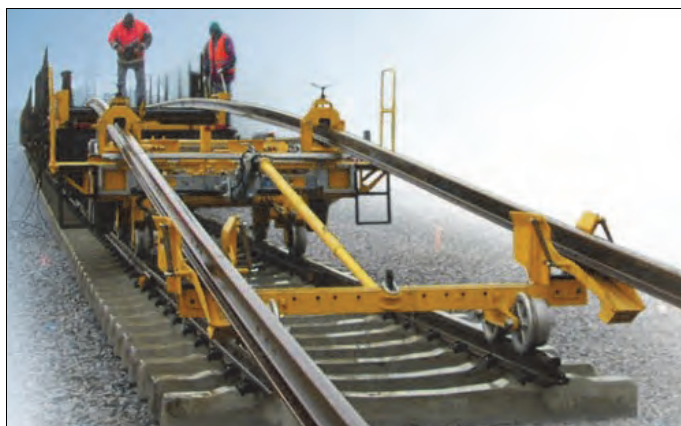
Rys. 9.16. System rozładunku szyn EMD [62]
