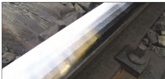
Rys. 8.40. Powierzchnia szyny po przejściu modułu frezującego [51]
