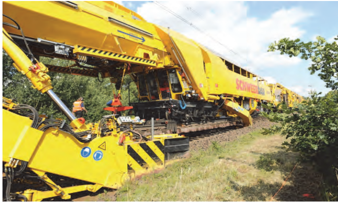
Rys. 11.38. Maszyna RPM RS 900 firmy Plasser & Theurer [68]: moduł wybierający (widoczny pierwszy i drugi łańcuch wybierakowy)
