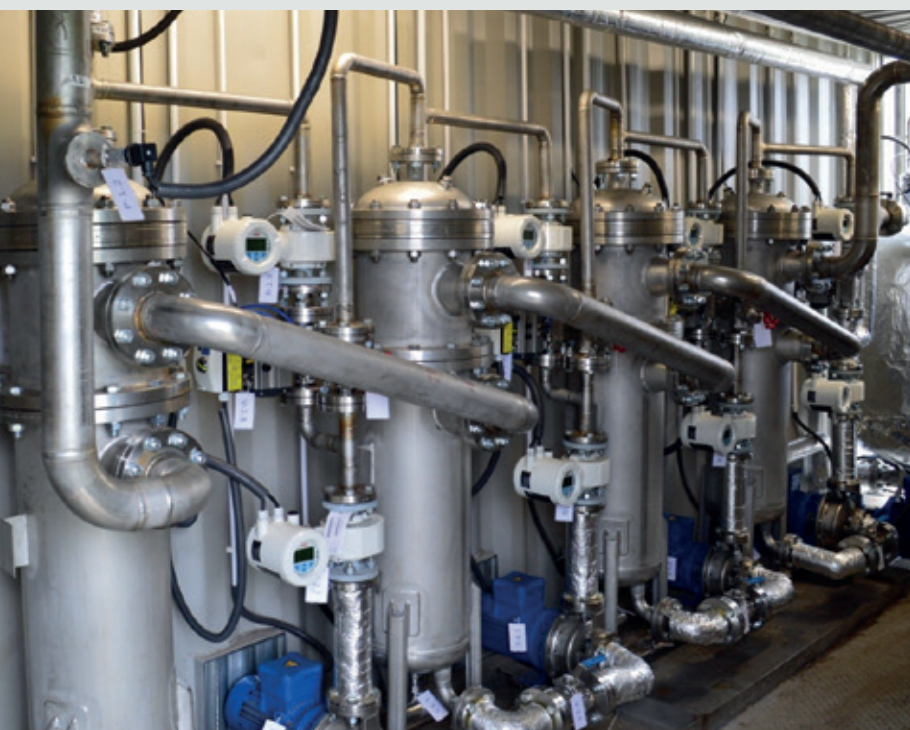
Fragment instalacji pilotażowej oczyszczania biogazu w Lubaniu
