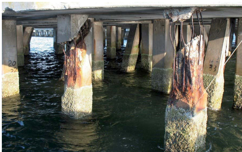
Rys. 2.5. Przykład korozyjnej destrukcji słupów żelbetowych wspierających konstrukcję mola. Za zgodą z [92]
