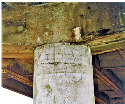
Rys. 2.1. Przykład korozyjnej destrukcji otuliny słupa żelbetowego. Jednosłupowy filar podpory pośredniej nieistniejącego od 2001 r. wiaduktu w ciągu ul. mjr. H. Sucharskiego w Gdańsku. Stan z roku 2000. Fot. M. Cichocki, za zgodą
